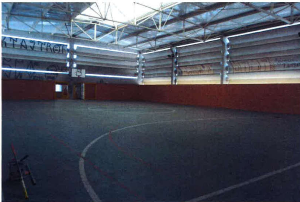
Pichação das placas de concreto na parte interior da quadra
