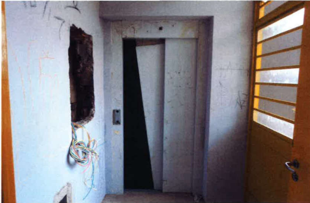
Supressão do painel de controle do elevador
